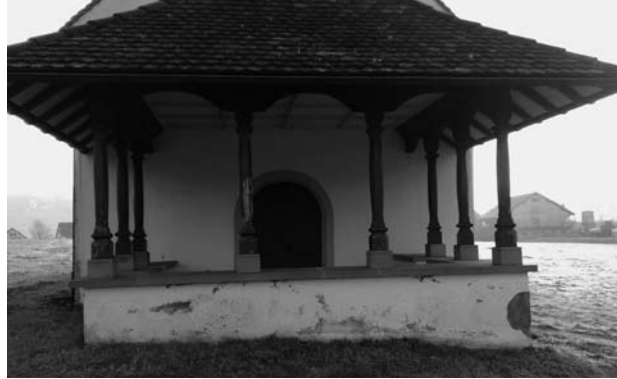
Das schadhafte Mauerwerk
